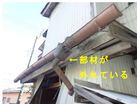
雨どいの垂れ下がり
