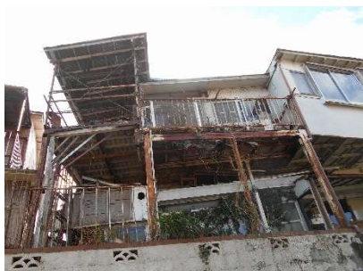
腐食したバルコニー
