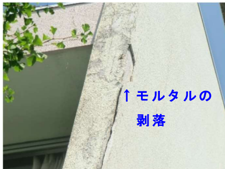
外壁の仕上材が剥落、腐朽又は破損し、下地が露出している
